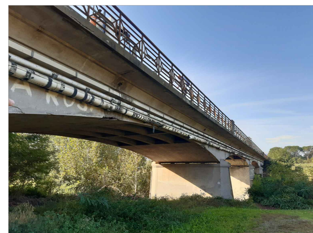
Prospetto di monte - tubazioni HERA (acqua e gas) e TELECOM (linea telefonica e fibra ottica) staffate sul lato esterno delle travi di riva dell'impalcato
