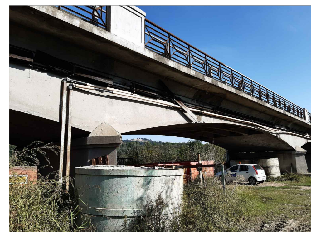
Prospetto di valle - tubazioni ACQUEDOTTO TERMALC staffate sul lato esterno delle travi di riva dell'impalcato
